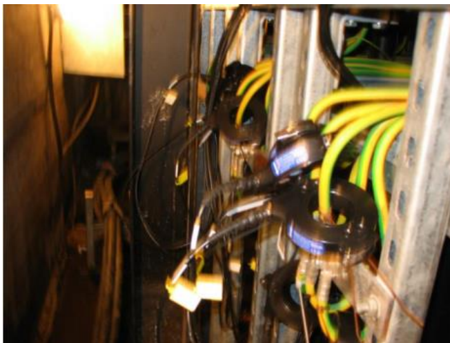
Высокочастотные трансформаторы тока, установленные на вывод заземления кабеля
