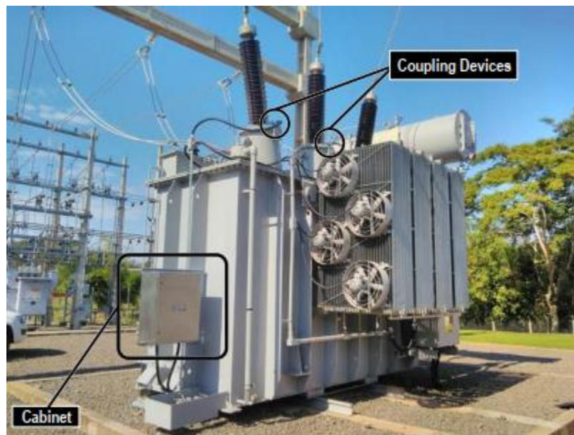
Система, установленная на трансформаторе 30 MVA
