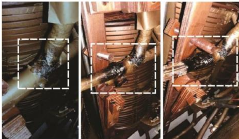
Обнаруженный дефект обмотки НН
