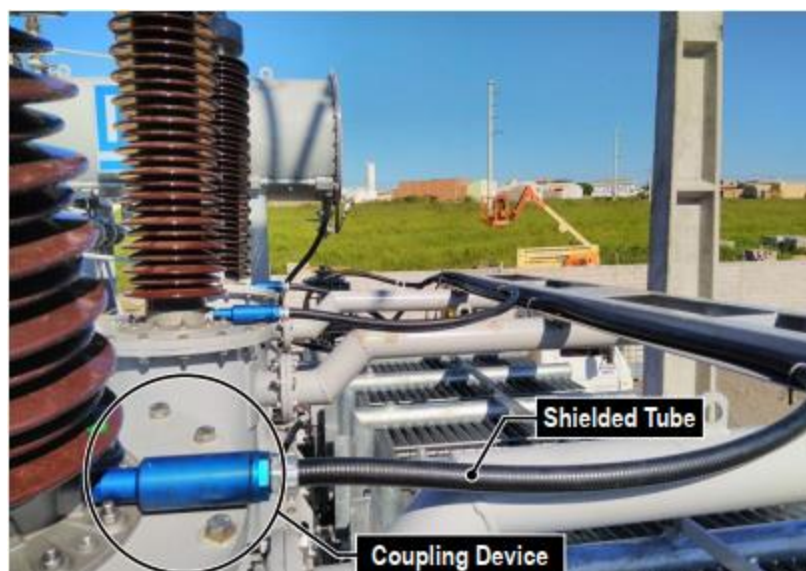
Датчик, установленный на вводе
